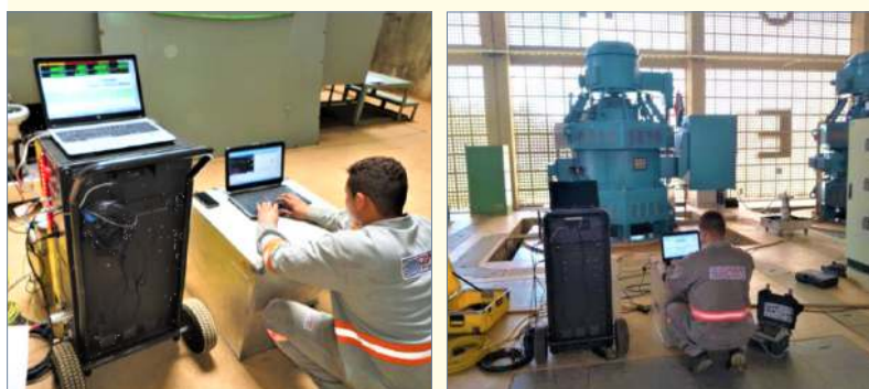
Manutenção preditiva "diagnose" dos motores elétricos" da EB-1 e EB-2
