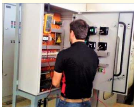
Aquisição de novo painel de excitação para motor da estação de recalque ER-C2
