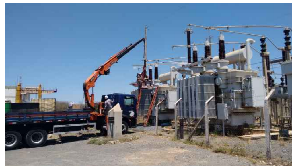
A manutenção preventiva nas subestações elétricas de alta tensão para garantir o melhor funcionamento das estações de bombeamento e evitar paradas inesperadas
